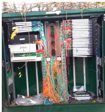
Armoires de Rue
